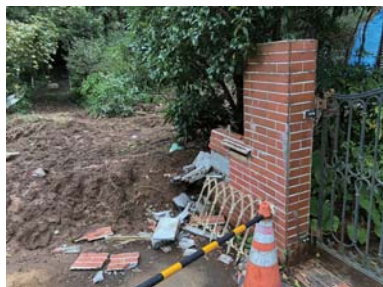
土砂崩れで門やエアコンが被害
